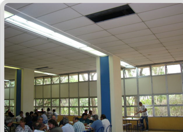
Teto do restaurante do IPEN está em péssimas condições.
